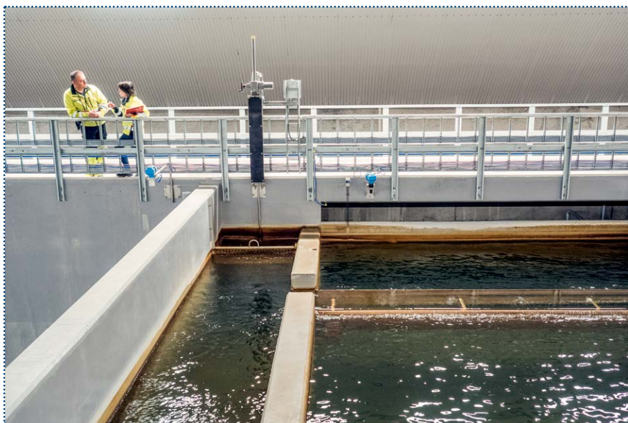
Fot. 2. Zakład produkcji wody Oset Vannbehandlingsanlegg w Oslo
